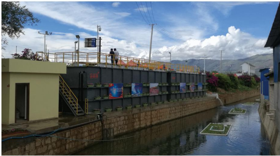
FMBR一体化设备乡镇废水
