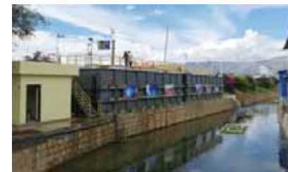
FMBR一体化设备乡镇废水
